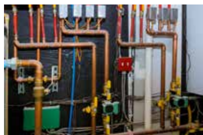
Kotle a výměníky tepla
